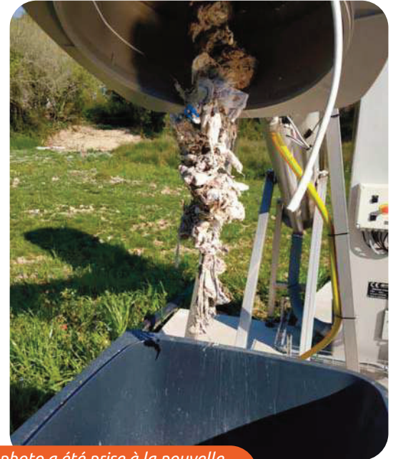
Cette photo a été prise à la nouvelle station de traitement des eaux usées de la commune !
