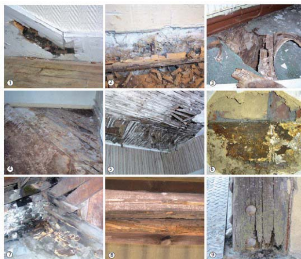
Dégâts occasionnés par le champignon à pourriture cubique Source Anah - Prévention et lutte contre les mэрules dans l'habitat - 2006
